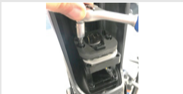
Figura 35: Aflojamiento de los tornillos del soporte del adaptador
